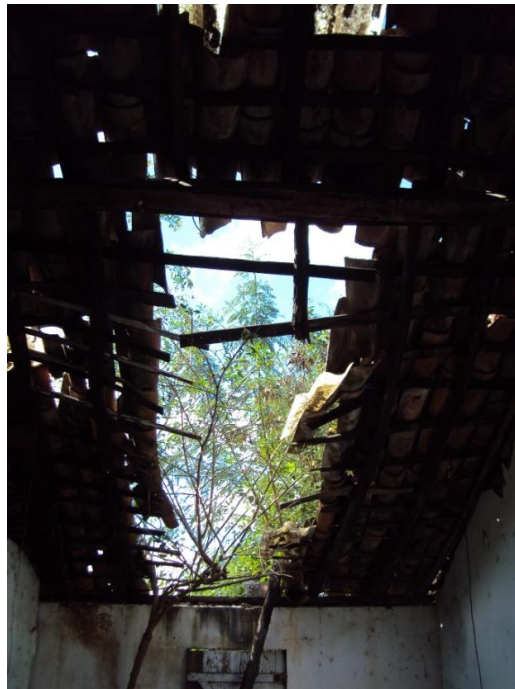
Foto 21 – Detalhe de partes do telhado desabado
